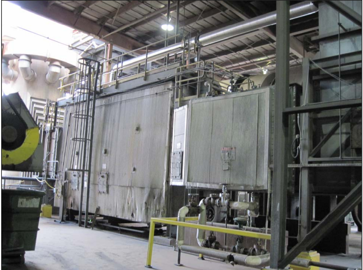
One of three HRSG boilers at Norbord
